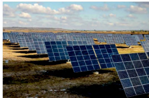
Des. 95. CES „Parcul Solar Suburban” cu module mobile (regiunea Dnipropetrovsk)
