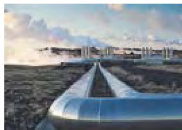
Rys. 12. Całkowite zabezpieczenie w energię ciepłą stolicy Islandii Reykjavik odbywa się od elektrowni geotermalnej, znajdującej się w 7 km od miasta
