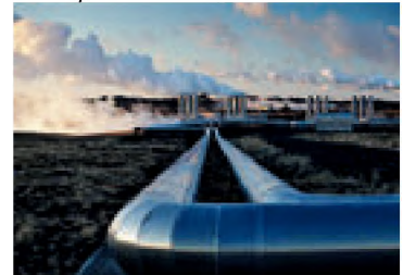
Fig. 12. Asigurarea termică a capitalei Islandiei Reykjavikului este complet realizată de centrala geotermică, situată la 7 km de la oraș
