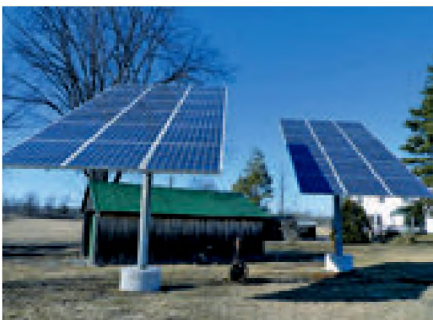
Fig. 9. Panelurile semiconductoare, instalate pe o suprafață privată
