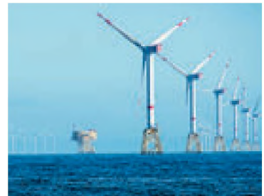
Fig. 11. Generatoarele eolaine, instalate de-a lungul malului în Danemarca, asigură complet necesitățile părții de nord a țării de energie și permit de a vinde energia electrică altor țări
