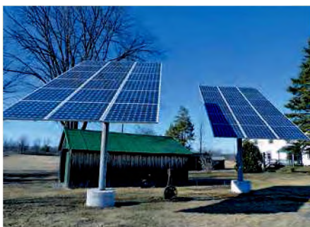
9. ábra. Magánterületen felállított félvezető napelemek
