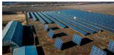
Рис. 58. Сонячна електростанція «Іванівка» (Україна)
