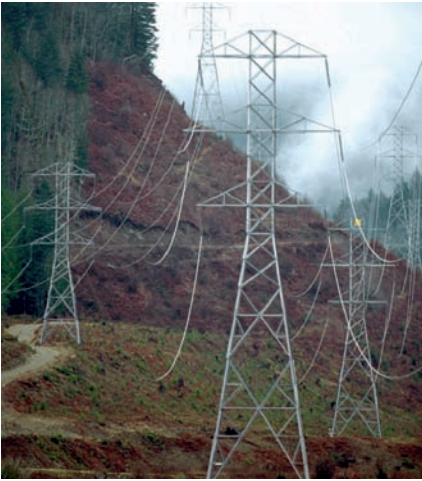
Опоры линий электропередачи
