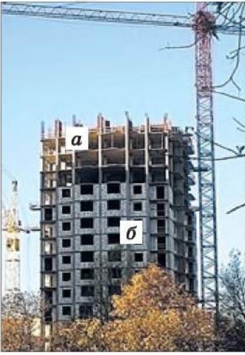
Будівництво багатоповерхового будинку: а — каркас будинку, спорудження опорних стін; б — наступний етап — закладання цеглою зовнішніх стін
