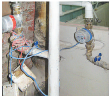
Мал. 20. Вентилі, що перекривають воду
