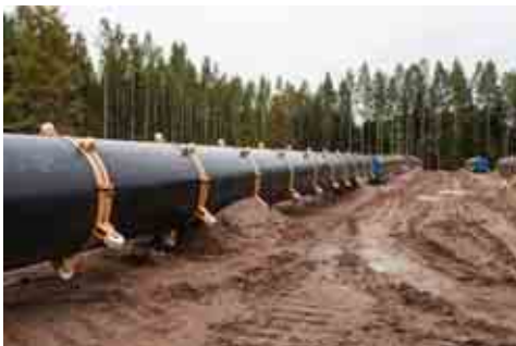
Мал. 52. Ділянка газопроводу
